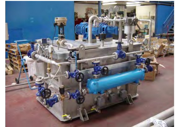
Central lubricación reductores
