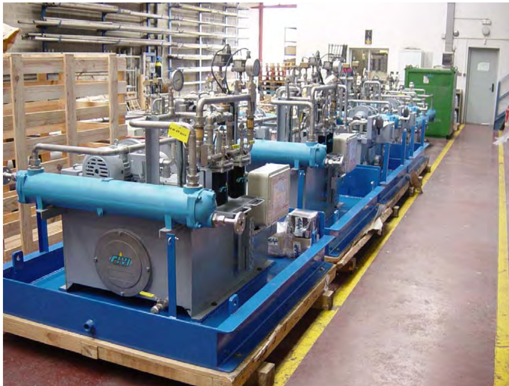
Centrales lubricación rodamientos bombas alimentación de agua – Bechtel (U.S.A)
