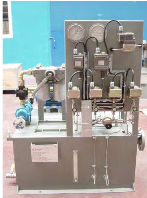
Lube Oil Unit, C.C.C. El Sauz (Mexico)
