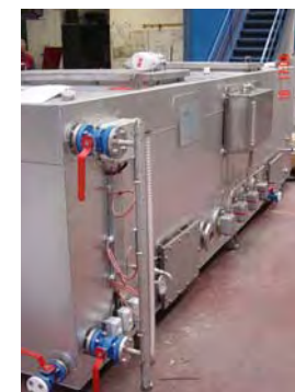
Depósitos AISI y calorifugados
